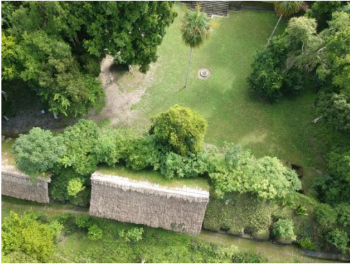
Fig. 3: fotografía aérea de la cubierta del edificio 219, nótese capa vegetal sobre la misma, la cual afecta directamente a la cubierta debido a la humedad que aporta y posteriormente descompone la hoja de Huano.
